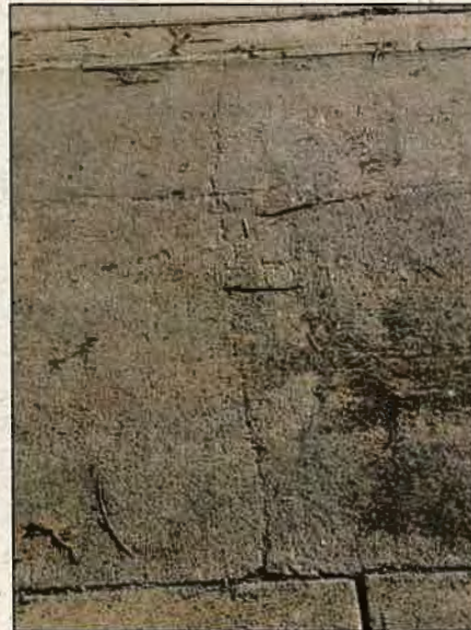
Foto N°8: Grieta en la superficie de la calzada.
