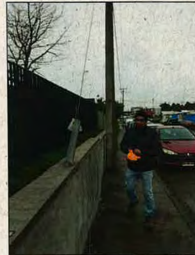
Foto N°4: Tirante de poste de alumbrado en el muro de contención. Construcción de muro de contención calle Luis Sáez Mora, tramo entre calle Pedro Eyheramendy y Libertad, Los Álamos.
