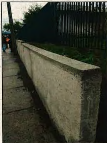
Foto N°3: Muro deformado. Construcción de muro de contención calle Luis Sáez Mora, tramo entre calle Pedro Eyheramendy y Libertad, Los Álamos.
