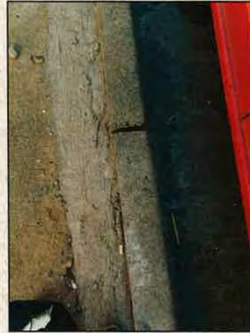
Foto N°6: Falta de emboquillado entre soleras.
