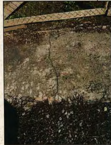
Foto N°12: Grieta en pastelón de la vereda.
