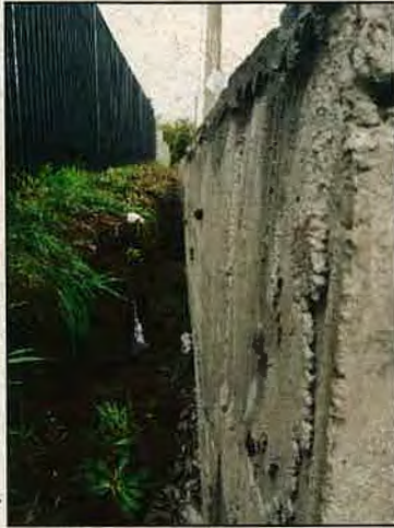
Foto N°5: Falta de relleno en la parte posterior del muro.
