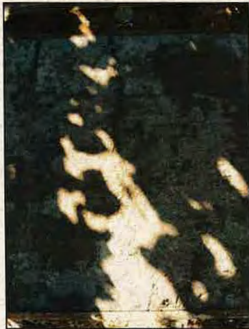
Foto N°11: Grieta en pastelón de la vereda.
