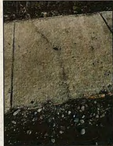
Foto N°10: Grieta en pastelón de la vereda.
