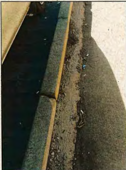
Foto N°7: Falta de emboquillado entre soleras.
