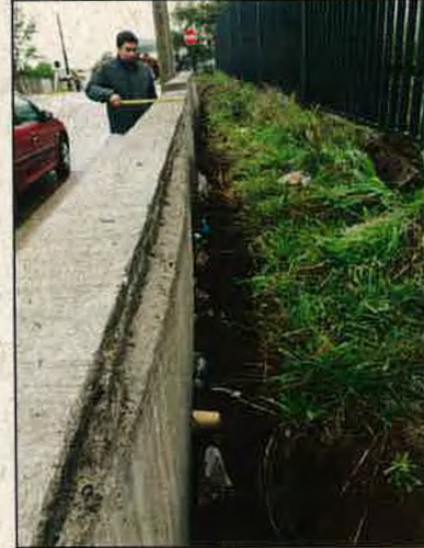
Foto N°2: Muro deformado. Construcción de muro de contención calle Luis Sáez Mora, tramo entre calle Pedro Eyheramendy y Libertad, Los Álamos.
